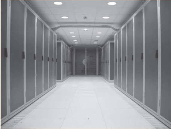
Ein Serverraum des Zentralen Informatikdienstes im Keller des Neuen Institutsgebäudes (NIG)
