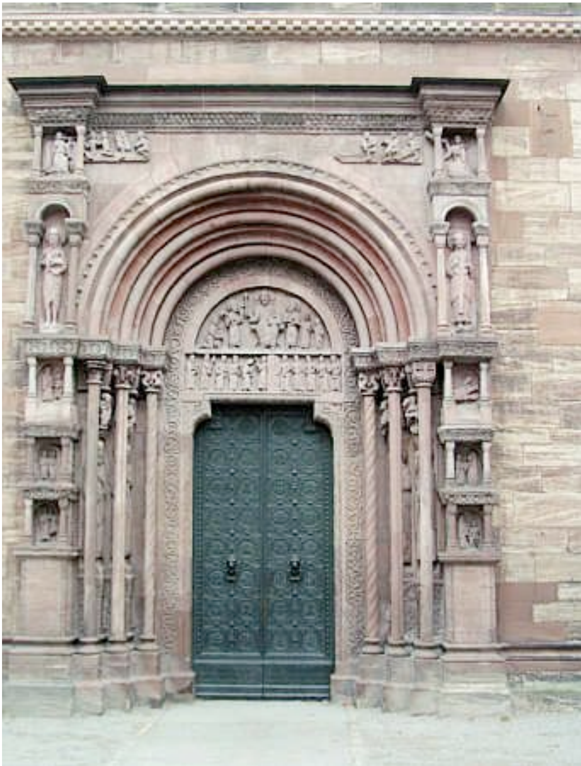
Abb. 160: Basel, Galluspforte vor Restaurierung von 1880/92 mit Kugelaufsätzen unter dem Gurtgesims und barocker Tür aus dem 18.Jhdt.
