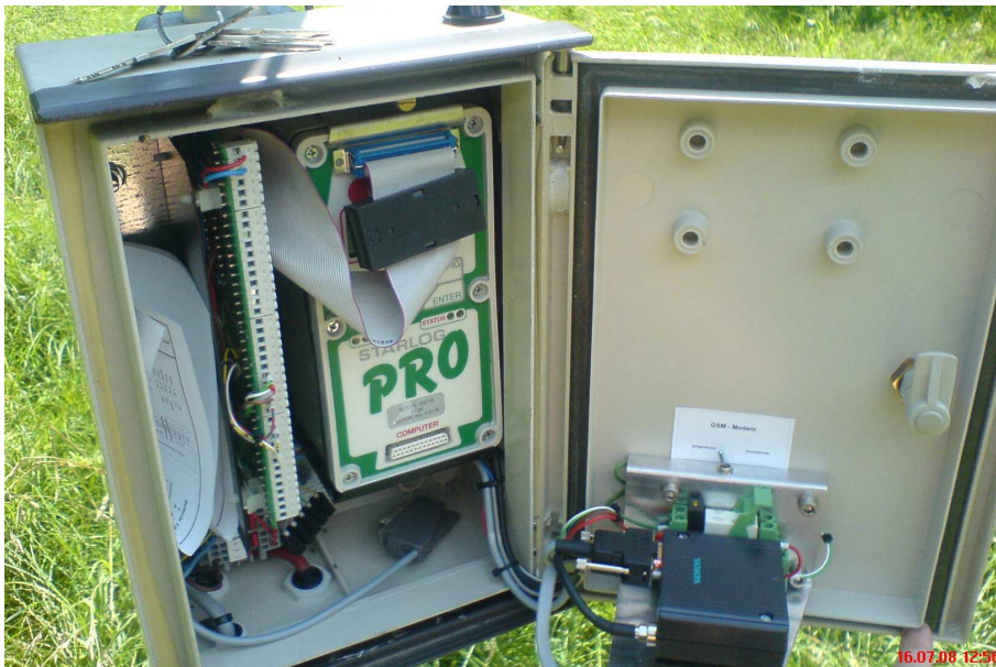
Abbildung 4: Im Schaltschrank befinden sich das GSM-Modem Siemens TC35 (rechts unten) sowie der Datenlogger vom Typ "UNIDATA Starlog ProLogger". Der Schaltschrank schützt die untergebrachten Geräte vor Feuchtigkeit und großen Temperaturschwankungen und stellt gleichzeitig einen rudimentären Strahlungsschutz dar.
