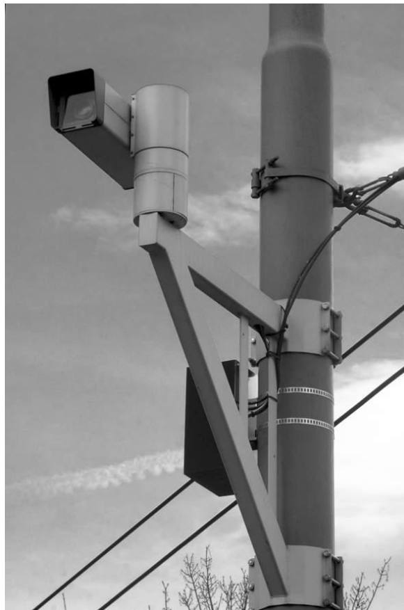
Abbildung 4: Videoüberwachungsanlage am Schwedenplatz
