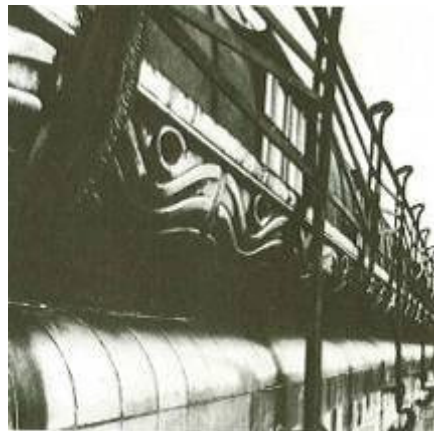
Abb.79: Dach-Verkleidung ornamental gelöst.
