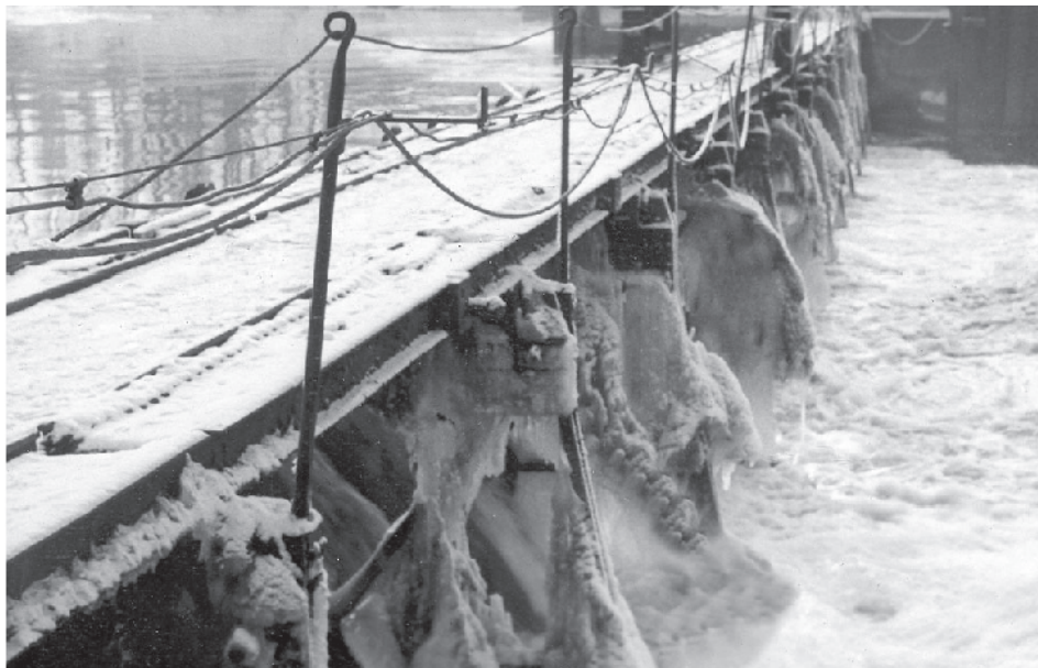
Abbildung 8: Ehemaliges Nadelwehr in Lovosice mit starker Vereisung
