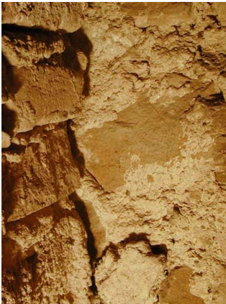
Abb. Nr. 123: Südseitenschiff, Dachboden, Ausbruchstelle Hochschiffwand
