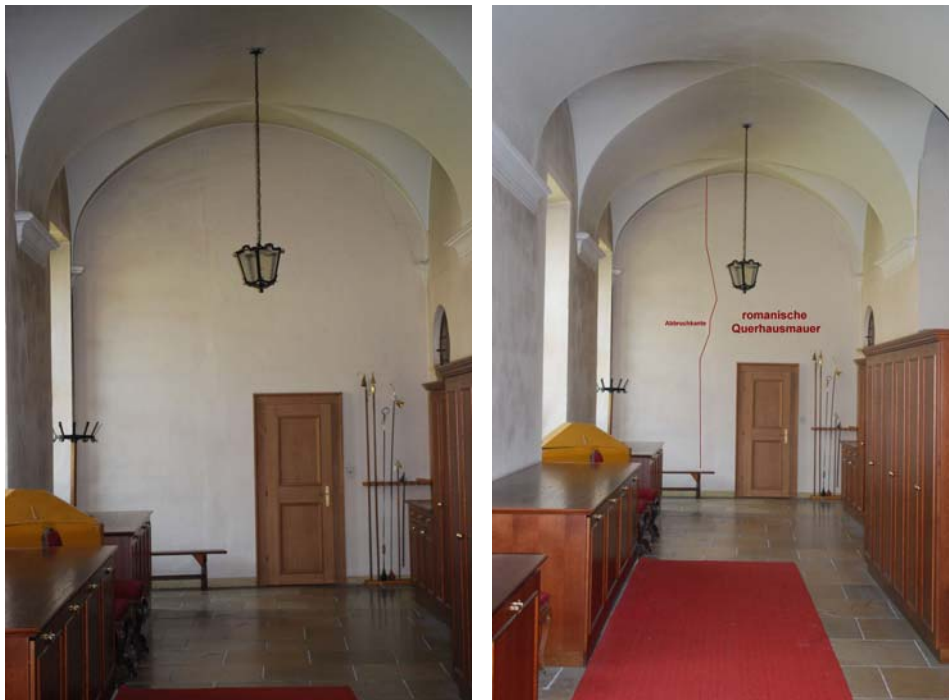
Abb. Nr. 180-181: Kreuzgang Obergeschoß, Blick Richtung Osten, Westwand der Wintersakristei (Bereich IV., Achse 0) Rissbild
