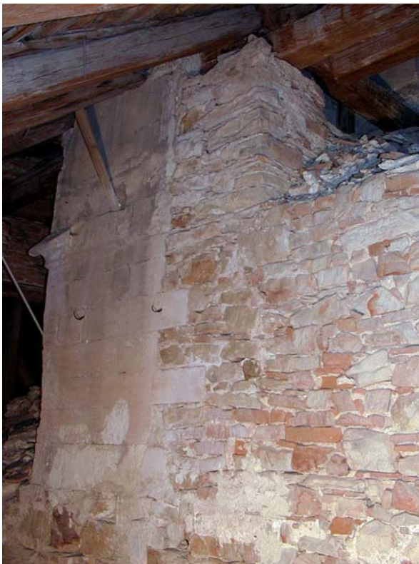
Abb. Nr. 165: Dachraum Kreuzgang, Bereich III. - IV., Achse 1 Seitenschiffwand – Strebepfeiler
