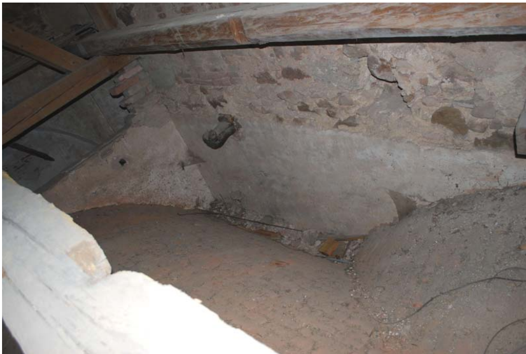
Abb. Nr. 203: Ehem. Stiftskirche Ardagger, Nordseitenschiff, Putzkante der ehem. Flachdecke sowie Konsolbalken
