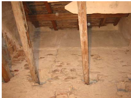
Abb. Nr. 160: Dachraum Kreuzgang/Nordseitenschiff, Bereich II., Mittelschiffwand – ehem. Dachansatz sowie Ansatz von Mauerpfeilern
