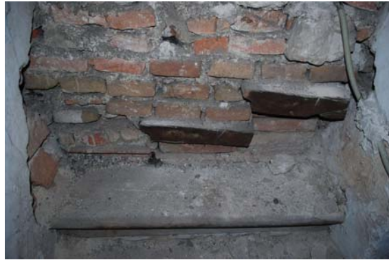
Abb. Nr. 46: Ehemaliger Emporenaufgang. Abmauerung im Bereich des 2. Laufes
