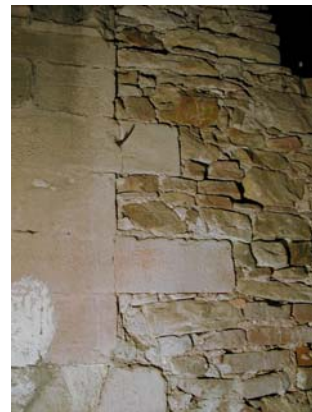
Abb. Nr. 166: Dachraum Kreuzgang, Achse 1 Verzahnung Seitenschiffwand – Strebepfeiler
