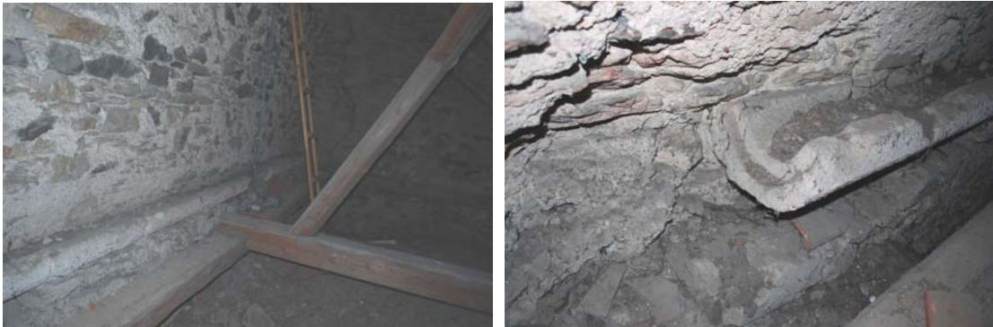
Abb. Nr. 309-310: Mautern Pfarrkirche, Nordkapelle Dachraum, steinerne Dachrinne zugehörig zum ehem. Satteldach der Nordkapelle
