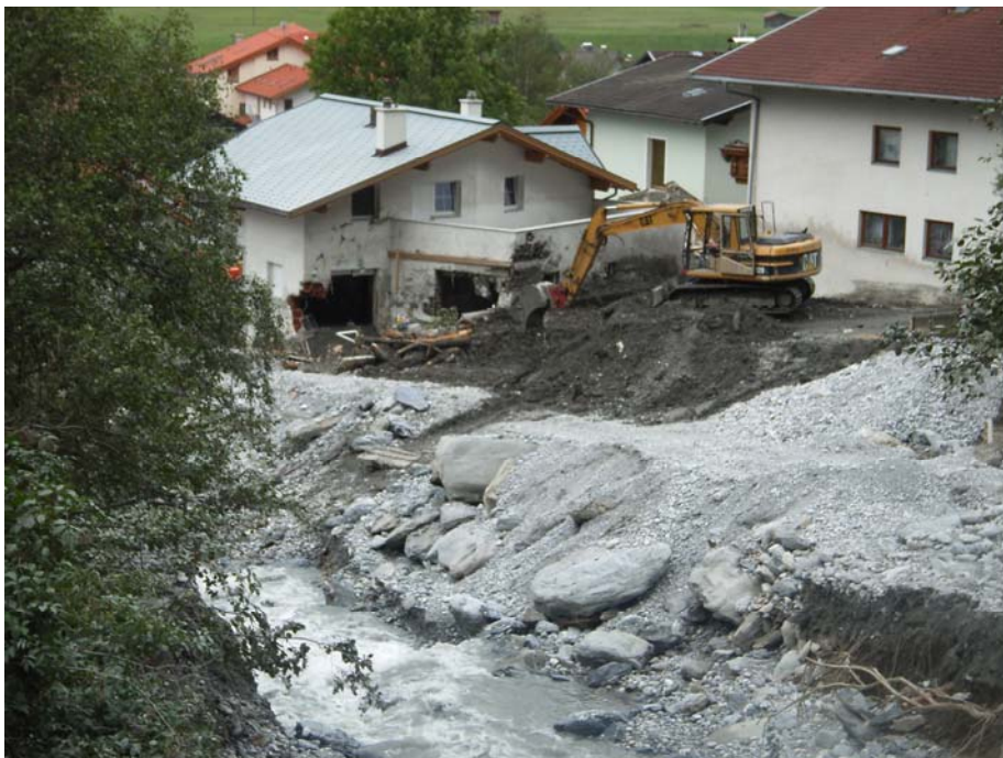
Abbildung 5.6: Aufräumarbeiten nach dem Ereignis im Ortsteil Stuben 2005: Das rechte Gebäude hatte Ablagerungen von 1 m ohne Materialeintritt aufgrund der hohen Positionierung der Fenster. (Foto: Institut f. alpine Naturgefahren, IAN)
