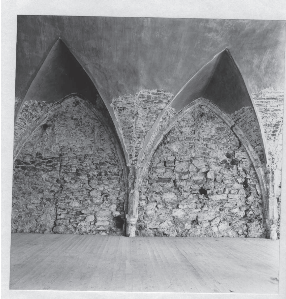
Abb. 13.: Kreuzkirche, Chor, Nordwand, vermauerte Fenster, die halb vom Gewölbe überschritten werden. Foto vom 11.5.1977
