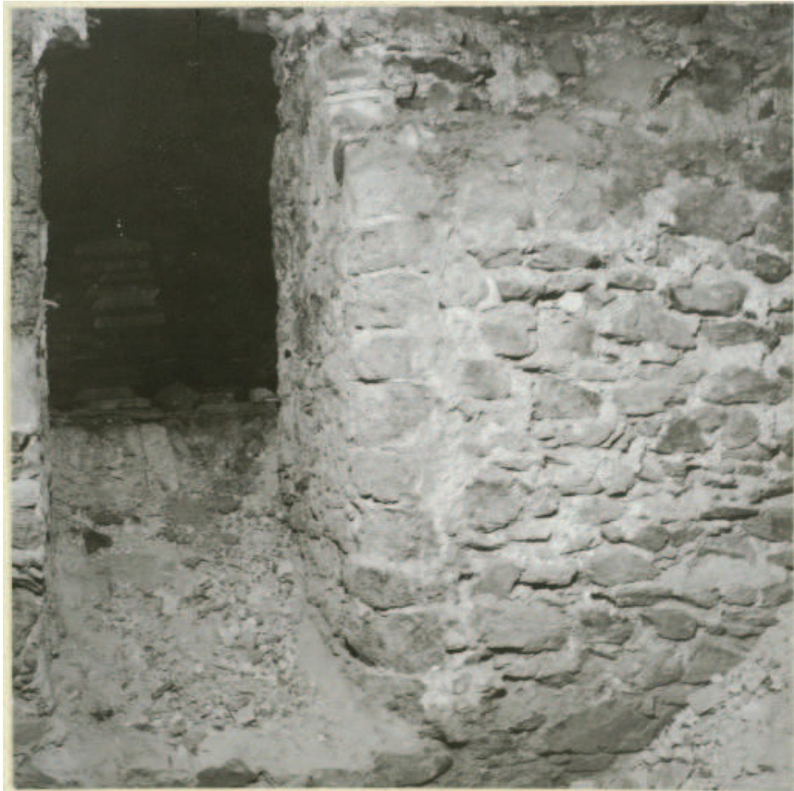
Abb. 78.: Marienkirche, Südturm Obergeschoss, Ostwand mit Durchgang ins Obergeschoss des südlichen Seitenschiffs. Foto vor 1968.
