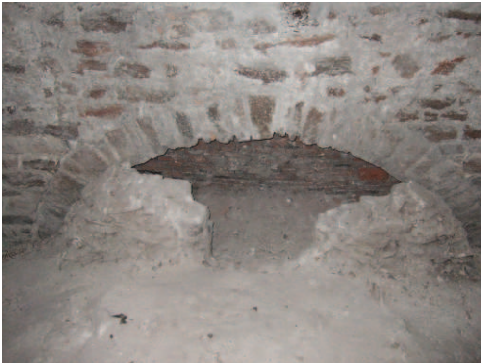
Abb. 56.: Kreuzkirche, Bogen an der Westwand über dem heutigen Emporengewölbe.
