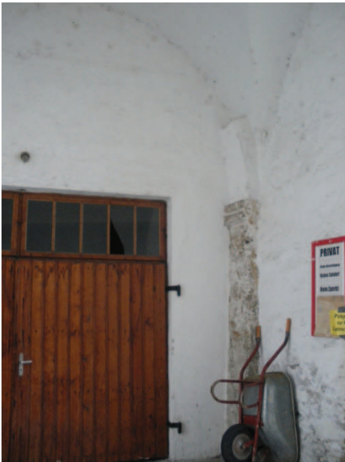
Abb. 73.: Marienkirche, dritter Südfeiler des Langhauses. Marienkirche, östlicher Wandfeiler im zweitwestlichsten Joch des südlichen Seitenschiffs.
