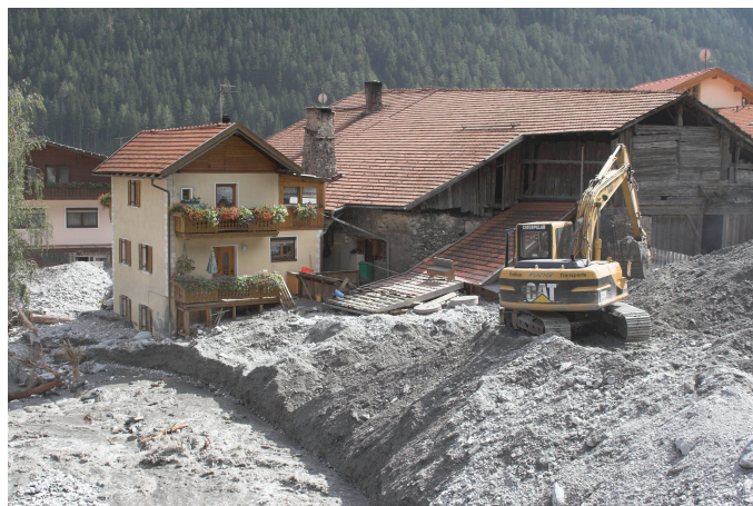
Abbildung 3.4: Geschiebeablagerungen mit Stubenbach im linken Bildrand (Foto: Ereignisdokumentation BOKU, IAN)
