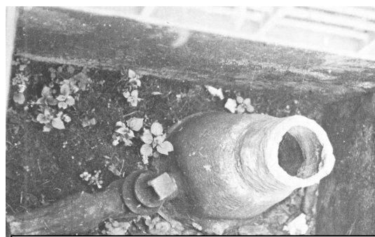
Abb.20 Bleibehälter mit Absperrhahn im Gehsteig versenkt
