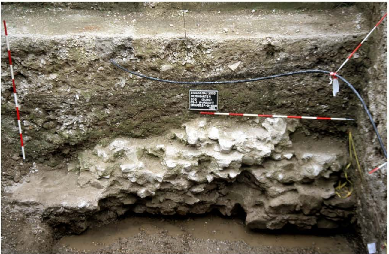
Abb. 52: S05, Westansicht 2, M1 mit Mauerausriss
