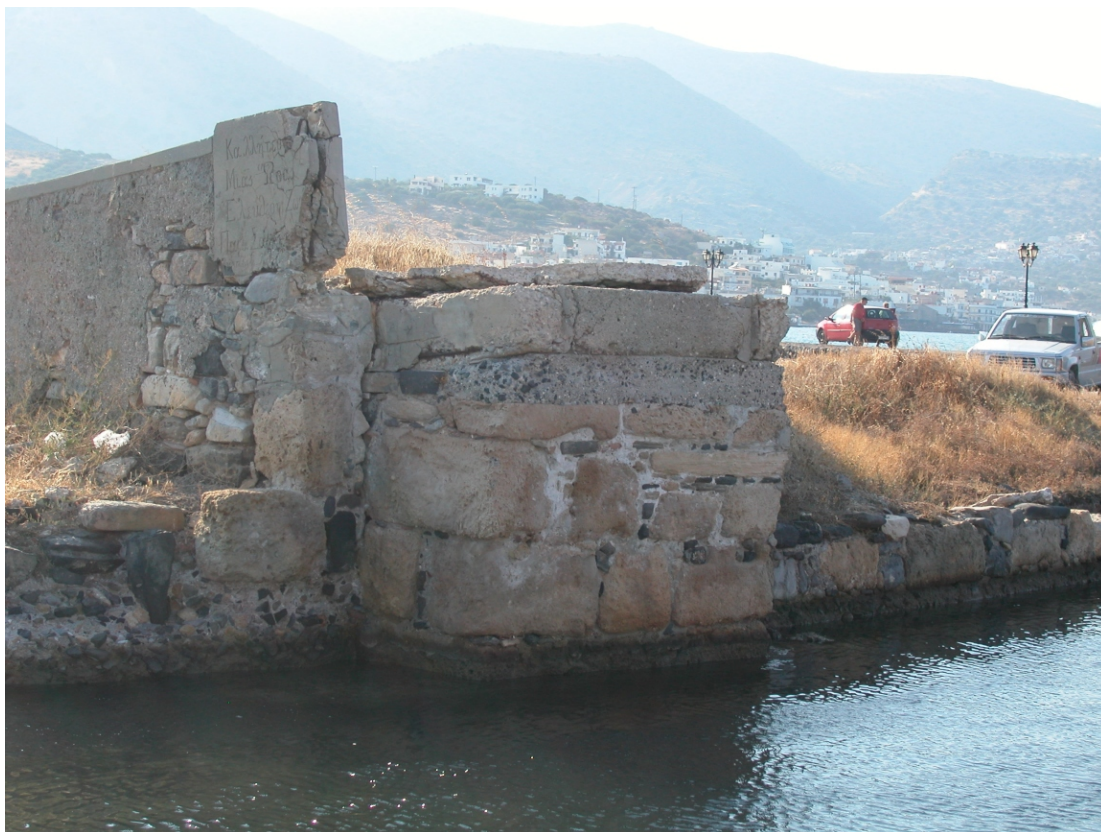
Abb. 72: Elounta, Kanal durch Isthmus, Auflager einer Brücke, antike Quadersteine in sekundärer Verwendung, möglicherweise von antiker Stadtmauer
