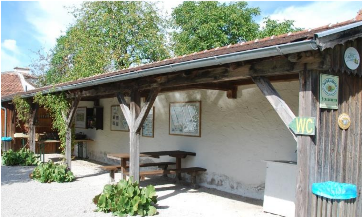
Abb. 18: Überdachung im Eingangsbereich mit veralteten Informationstafeln an der Wand (Sommer 2015)
