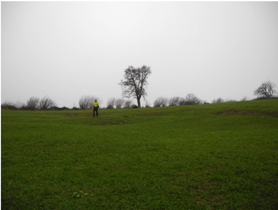
Abbildung 15: wellige Morphologie und Risse in der Vegetationsdecke oberhalb der Abrisskante der Rutschung, Foto: K. Fila
