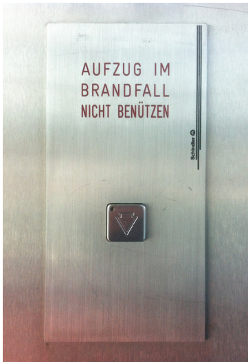
Abbildung 1: Aufzug im Brandfall nicht benützen 1 (Foto von Michael Bouda 2016)
