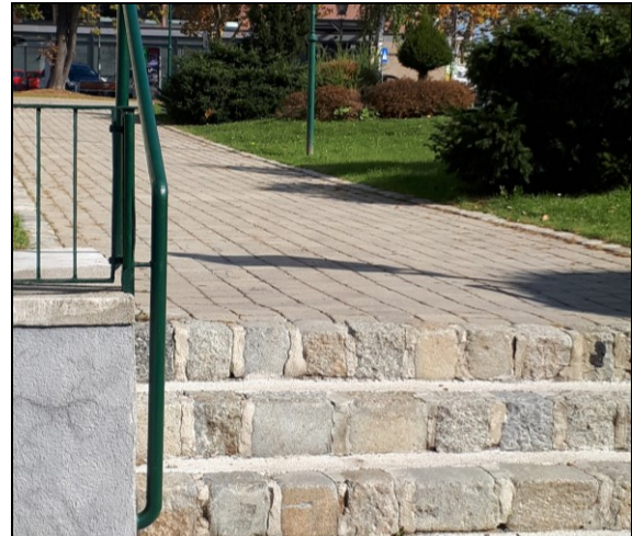
Foto 7: Treppen als Barrieren am Bildungszentrum, Franz – Dinhobl – Straße 2 Quelle: eigene Aufnahme 09.10.2018
