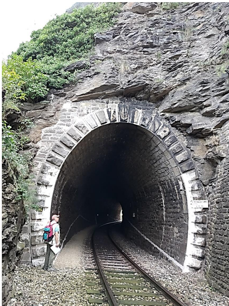
Abbildung 19: Ansicht Ostportal, die Schieferung des Gesteins in der Tunnelfirste.
