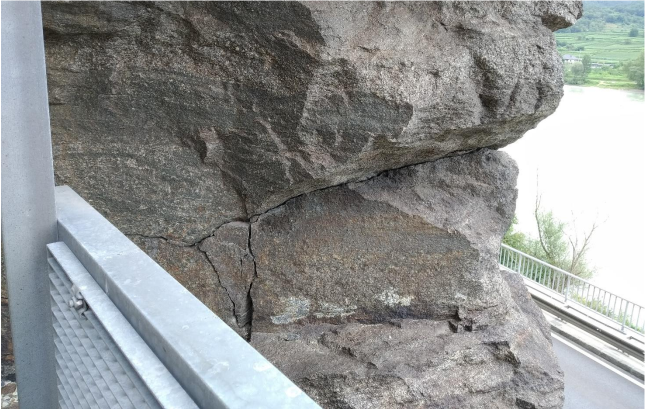
Abbildung 142a Detail von Abb. 136 :Standort des Zugrisses im Westportal. In den Abbildungen man kann sehen, dass die Spannungsrisse parallel zu den Böschungen liegen.
