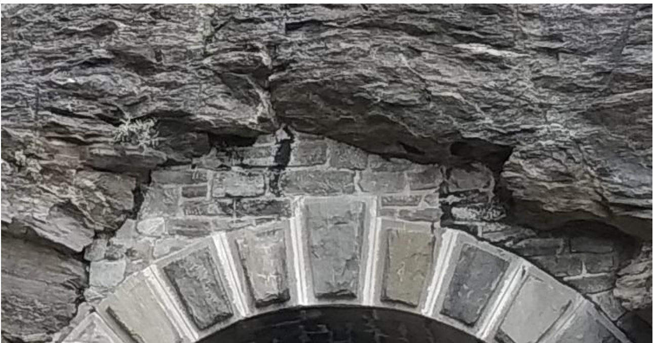
Abbildung 143b Zugrisse über der Firste am Westportal.
