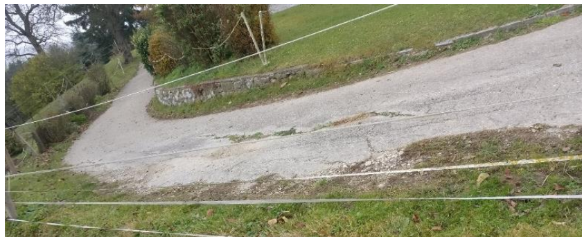
Abbildung 16: 4441 Behamberg Schäden an Straße
